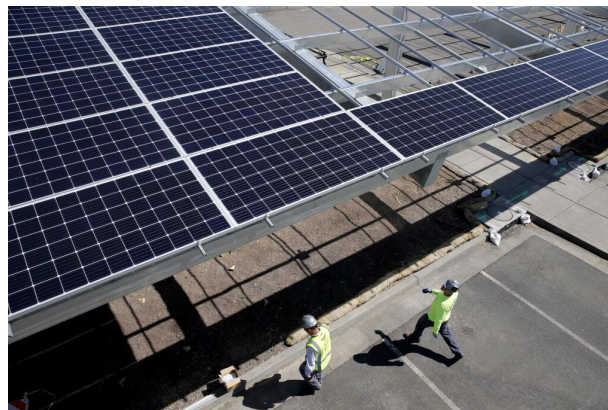
Santa Rosa PV Array
